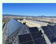
市役所本館屋上に設置された太陽光発電設備
