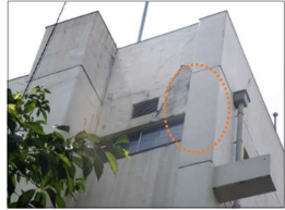
市役所本館（外装材の剥落）
