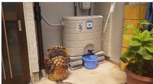
雨水貯留タンク設置例
