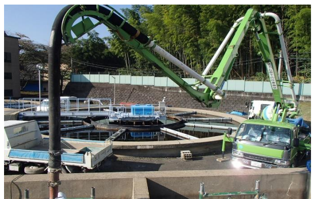
酸化池（平成29年度竣工）
