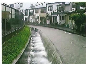
雨水流入施設（寺戸川〔永田〕流入口）
