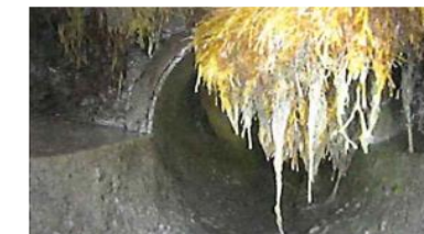
木根侵入箇所
