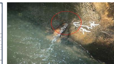
浸入水発生箇所
