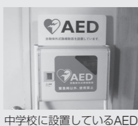
中学校に設置しているAED
