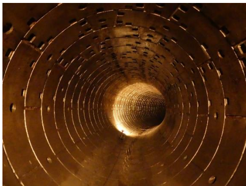
雨水トンネル石田川1号幹線
