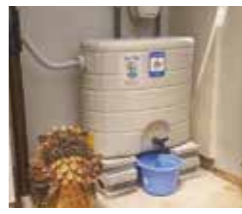
雨水タンク設置事例
