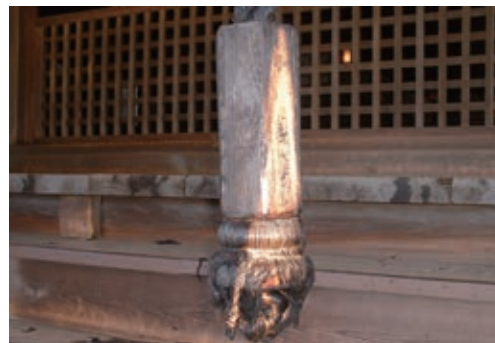
写真 5-5-2 文化財建造物への放火
