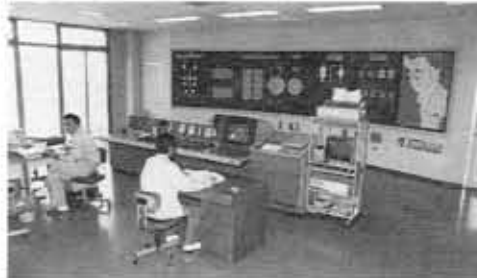
▶中央管理室(上植野浄水場) 水量の調節や機械の操作など、3浄水場の集中管理をしています。
