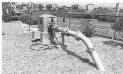
▶取水井 深さ130~200mの地下水を、水中ポンプで汲み上げる井戸です。
