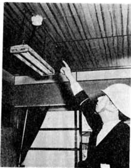
(取付けた火災報知器)
