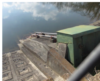
写真 2-4-3-3 寺戸・はりこ池の樋
