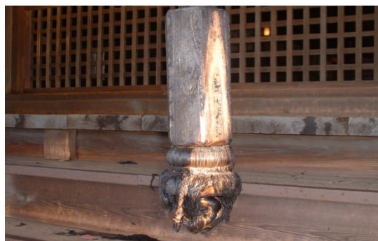
写真 5-5-2 文化財建造物への放火
