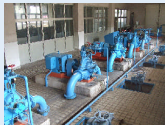
浄水池の送水ポンプ
