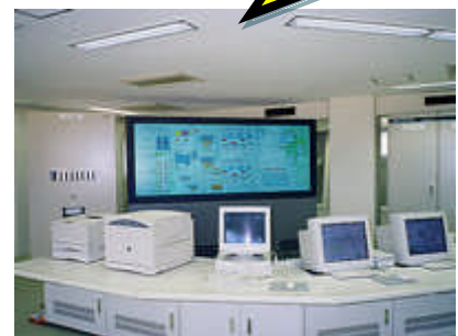
中央監視装置
