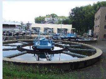
高速凝集沈澱池
