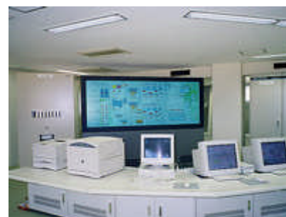
中央監視装置
