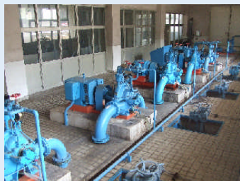
浄水池の送水ポンプ
