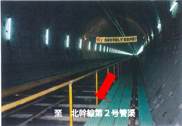
②雨水北幹線第1号管渠工事中(径8.5m) 至 北幹線第2号管渠
