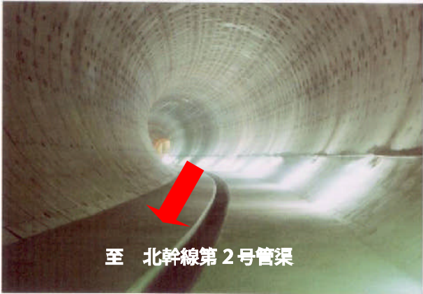
③雨水北幹線第1号管渠供用中(径8.5m) 至 北幹線第2号管渠
