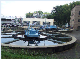
高速凝集沈澱池
