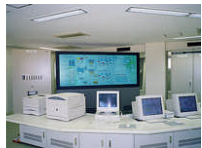
中央監視装置
