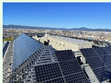
市役所本館屋上に設置された太陽光発電設備
