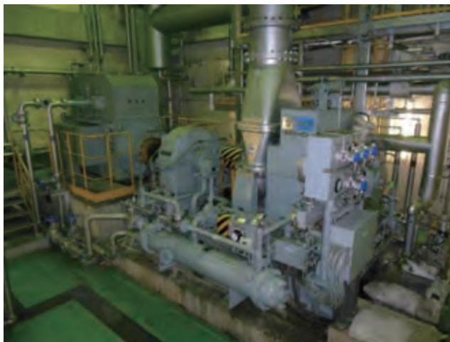
ごみ処理施設に設置されている発電機(蒸気タービン)
