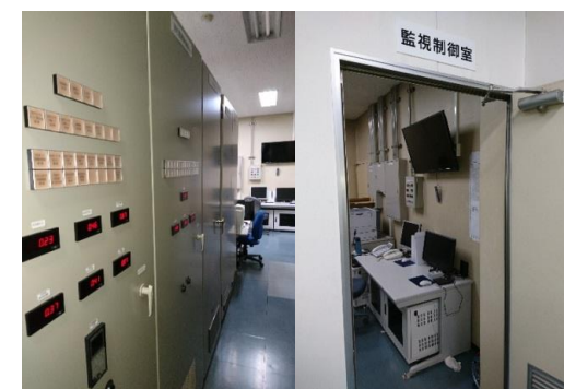
〈上植野浄水場：監視制御設備〉
