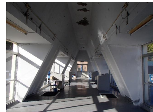
急速ろ過池(建屋内)
