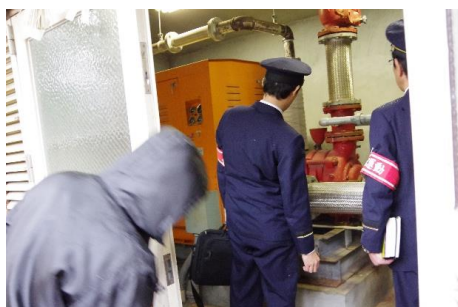
防火設備点検(向日神社)
