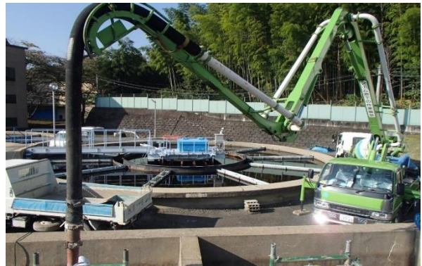
酸化池（平成29年度竣工）
