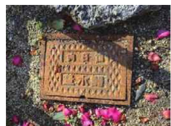
給排水施設(量水器)
