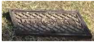
給排水施設(止水栓・量水器)
