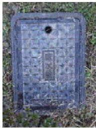
給排水施設(散水栓)
