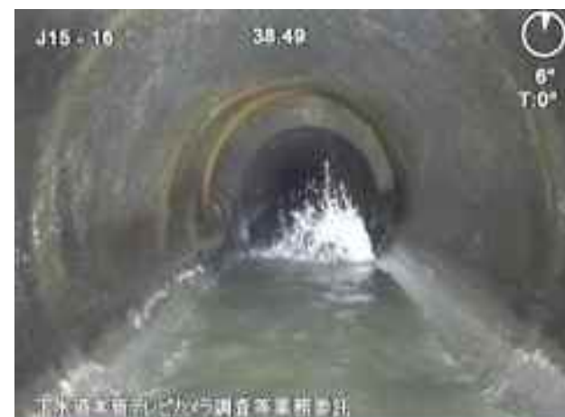
本管テレビカメラ撮影画像（浸入水発生箇所）
