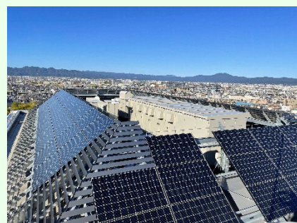
市役所本館屋上に設置された太陽光発電設備 学校で育てられ 太陽光発電設備
