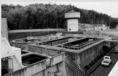
物集女西浄水場
