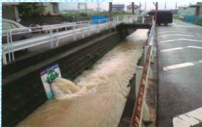
放流施設(寺戸川)(阪急洛西口駅付近)
